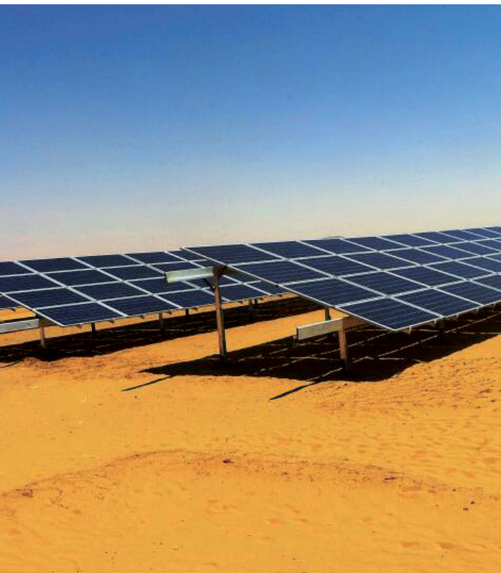
Wüsteninstallationen (bis zu 50 °C)
